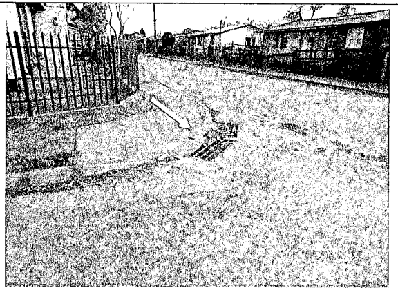
FOTO N° 27 DISPOSITIVO DE RODADO SOBRE SUMIDERO
