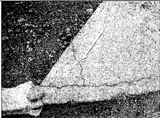
FOTO N° 8 GRIETA EN DISPOSITIVO DE RODADO
