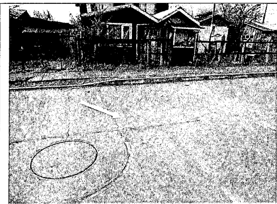
FOTO N° 28 FISURA EN LOSA DE PAVIMENTO
