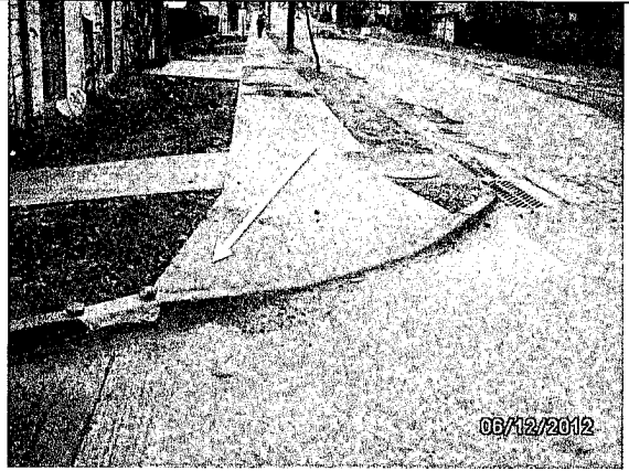
FOTO N° 7 GRIETA EN DISPOSITIVO DE RODADO
