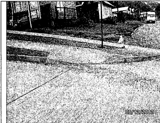
FOTO Nº 1, SOLERAS SIN EMBOQUILLADO
